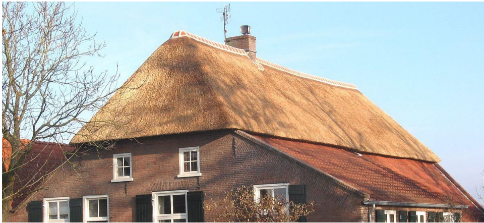
Het pannengedeelte is minder steil dan het rietgedeelte (Wikipedia).
